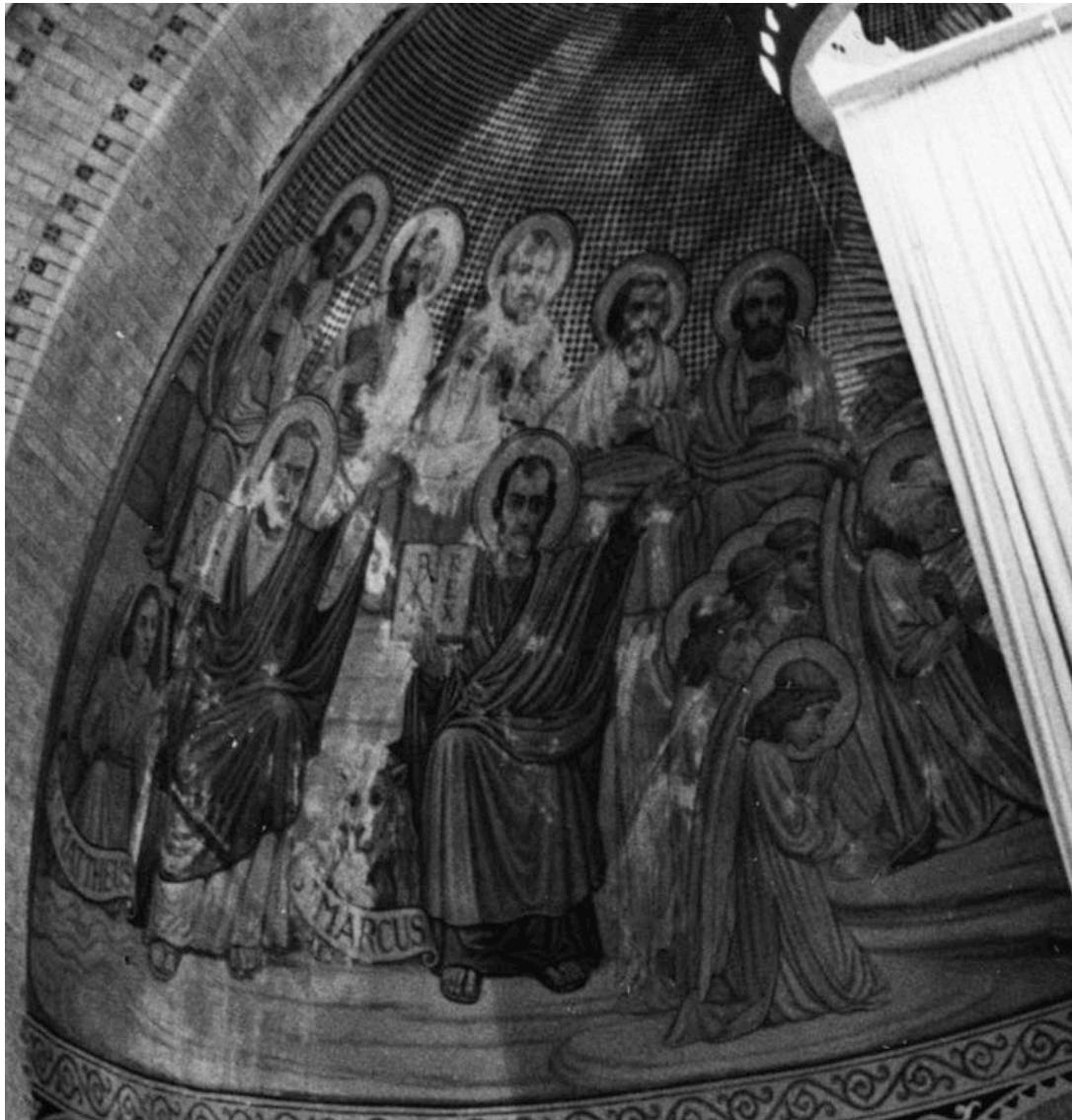
afb. 42 Geroteerd detail van een historische foto met het linkerdeel van de kalot. Heel duidelijk is de schade van salpeter. Foto F.H. van Dijk 1954. Herkomst Stadsarchief Rotterdam, nummer 4100_1976-14509.
